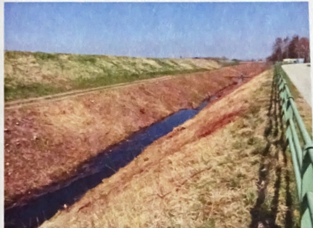
Abbildung 35: Nördlicher Rubringer Graben. Der Ufergehölzsaum wurde vollständig entfernt.
