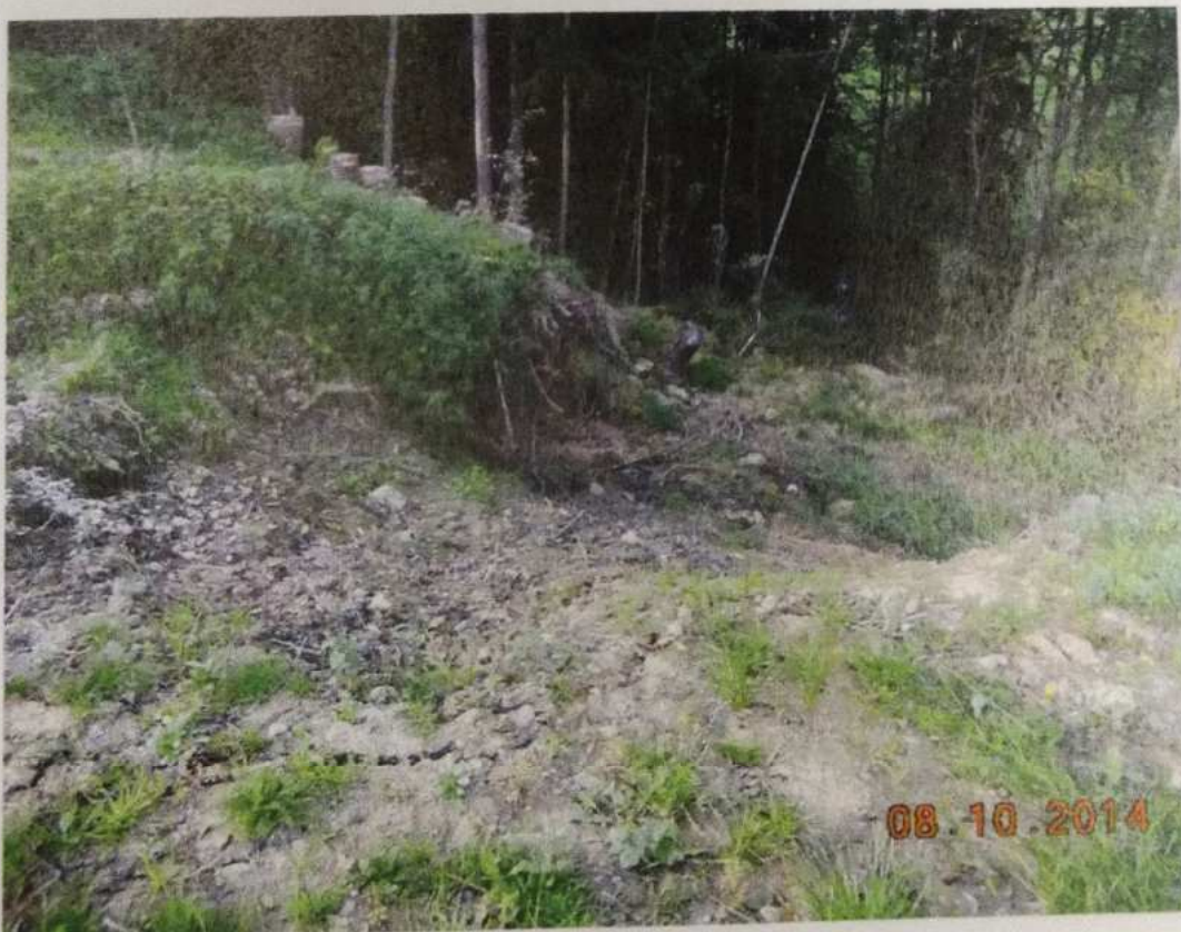
Bild 2: Hangrutschung, vom Güterweg in Richtung Krößbach
