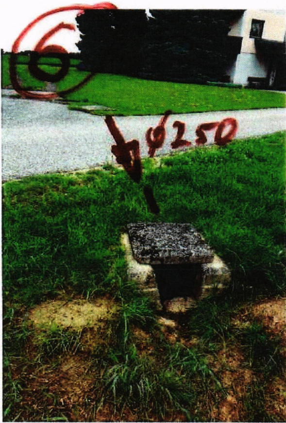
Foto 6+7: Ab diesem Schacht geht eine Drainage mit D200 bis zur Straße Güterweg Schwaben.
